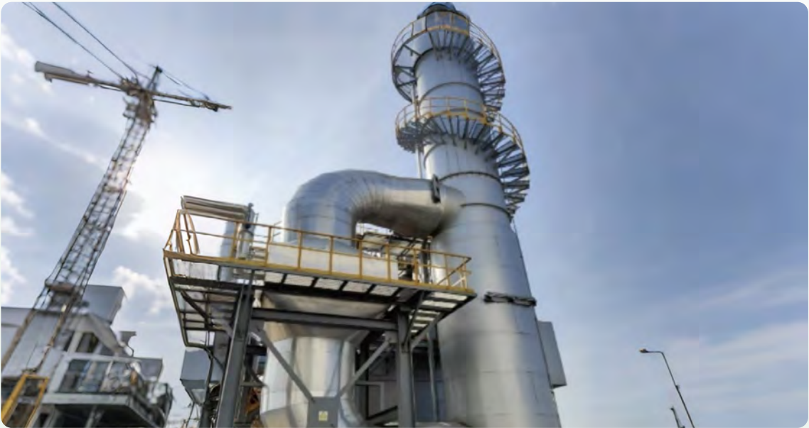
杉金光电（张家港）RTO 废热回收装置
