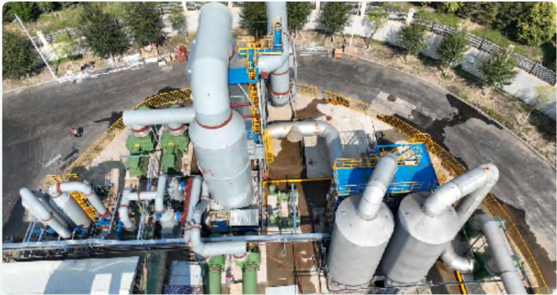
新改造尾气站航拍图
