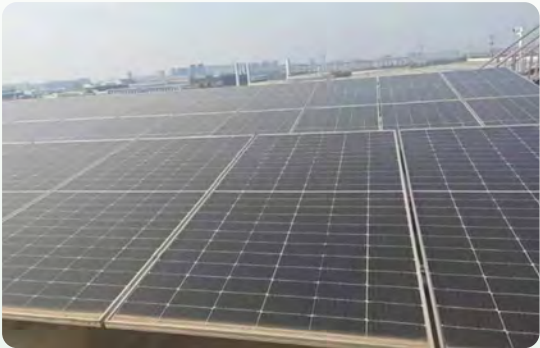
杉金光电（张家港）光伏项目
