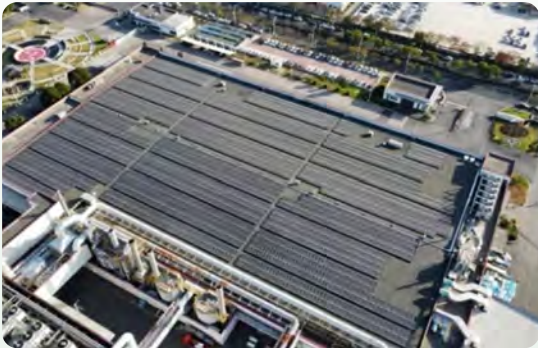
杉金光电（南京）光伏项目
